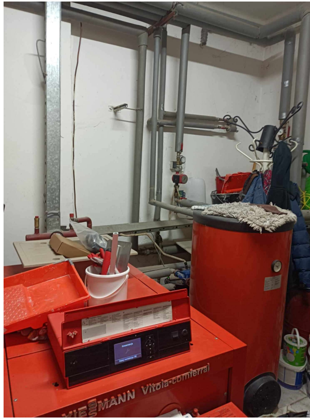
Rys. 9 Kotłownia w budynku wraz z armaturą i przewodami
